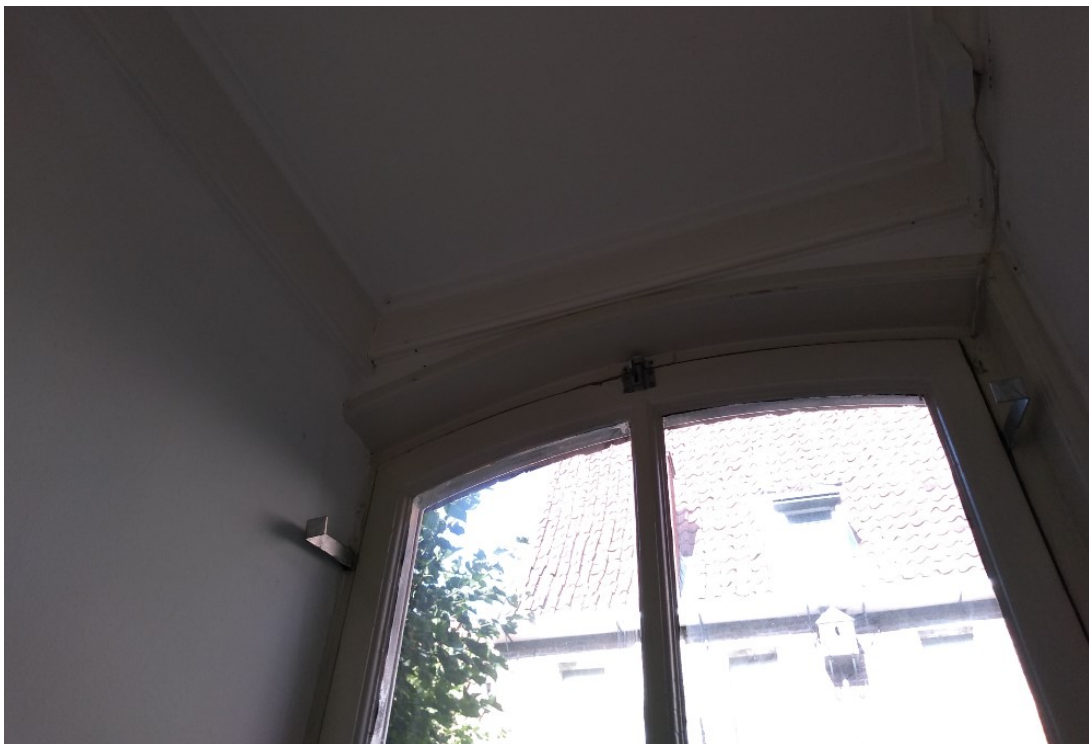
Afbeelding 46: Bij de voordeur valt een deurstijl weg. De 8cm dikke lichte wand is er tegenaan gezet.
