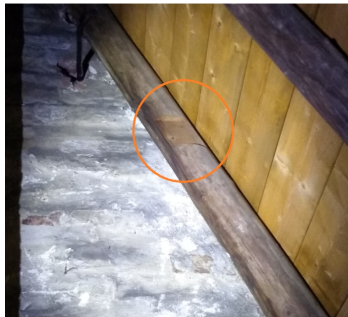
Afbeelding 23: Daksporen (oranje omcirkelt) met ontbrekende haanhout ter plaatse van een schoorsteen doorbraak.
