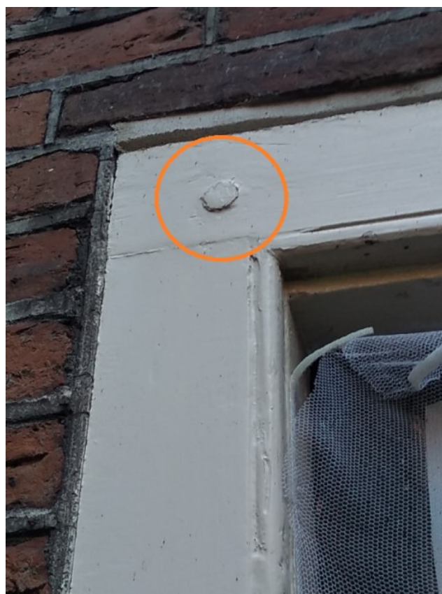
Afbeelding 71: Oranje omcirkelde toognagel met een afgerond profiel aan de dagkant van het kozijn.
