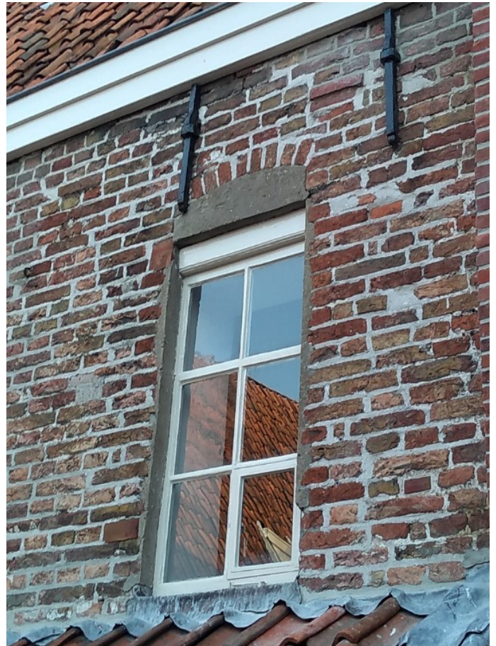
Afbeelding 21: De positie van de zoldervloer gevelankers sluiten niet aan op de onderliggende gevelankers.
