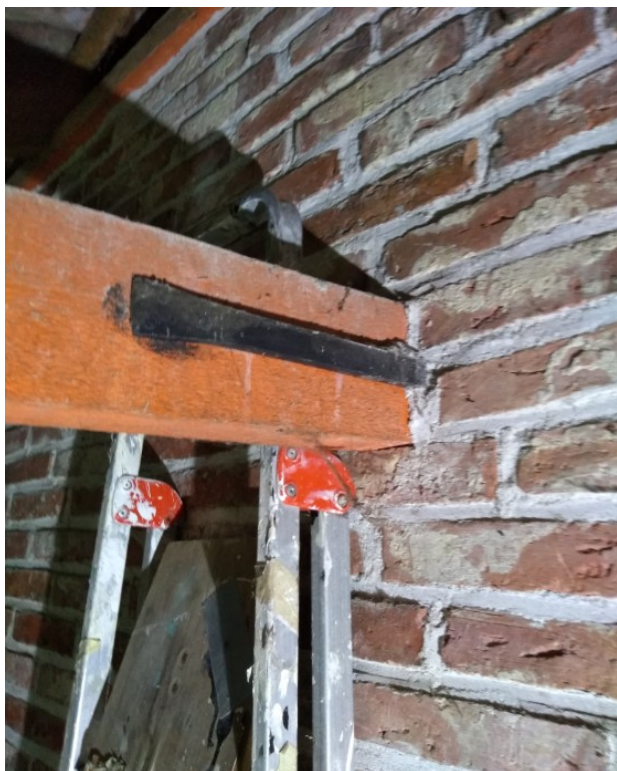
Afbeelding 36: Trekbalk behandeld met menie. De achtergevel is in een moderne klezoor- halfsteens verband gemetseld.
